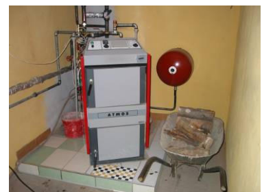
Jeden z kotlů na dřevo pronajatých obyvatelům obce Salaš
