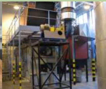
Obr. č.3 – Kotelna na dřevní štěpku
