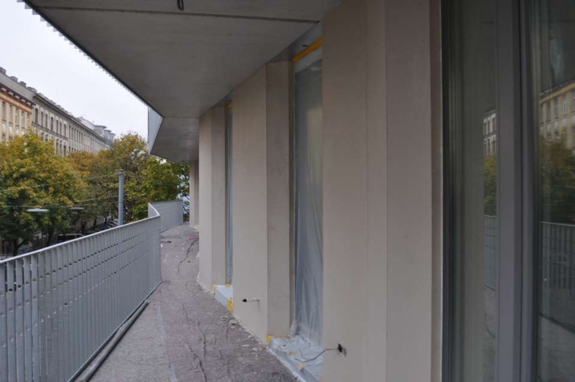
VÍDEŇ – ZKOSENÁ OSTĚNÍ U OKEN PASIVNÍHO DOMU
