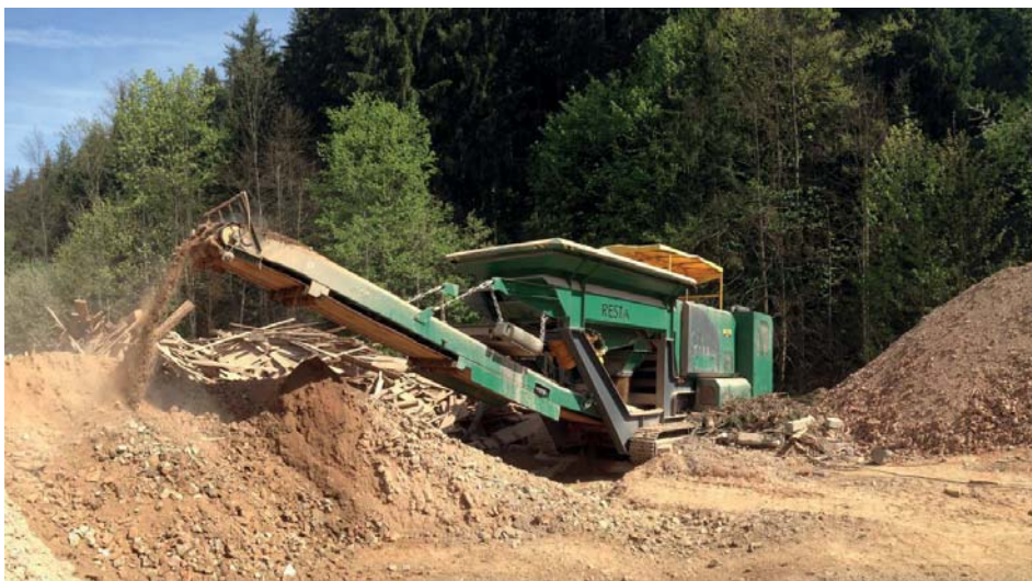
Zařízení k recyklaci stavebních odpadů
