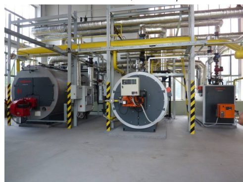
Nemocnice Uherské Hradiště, kotelna - po realizaci
