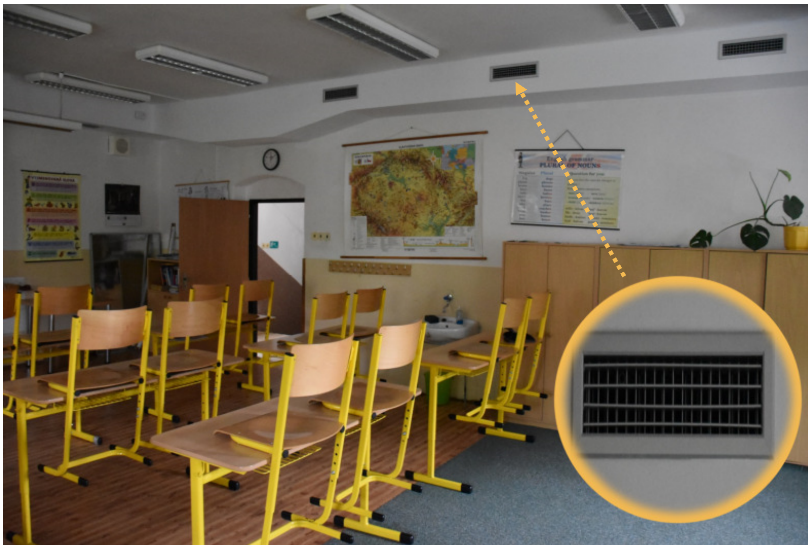
Obr. 3: Nové řešení VZT ve třídách ZŠ Hudlice, distribuce vzduchu mřížkami do potrubí, zdroj: EkoWATT
