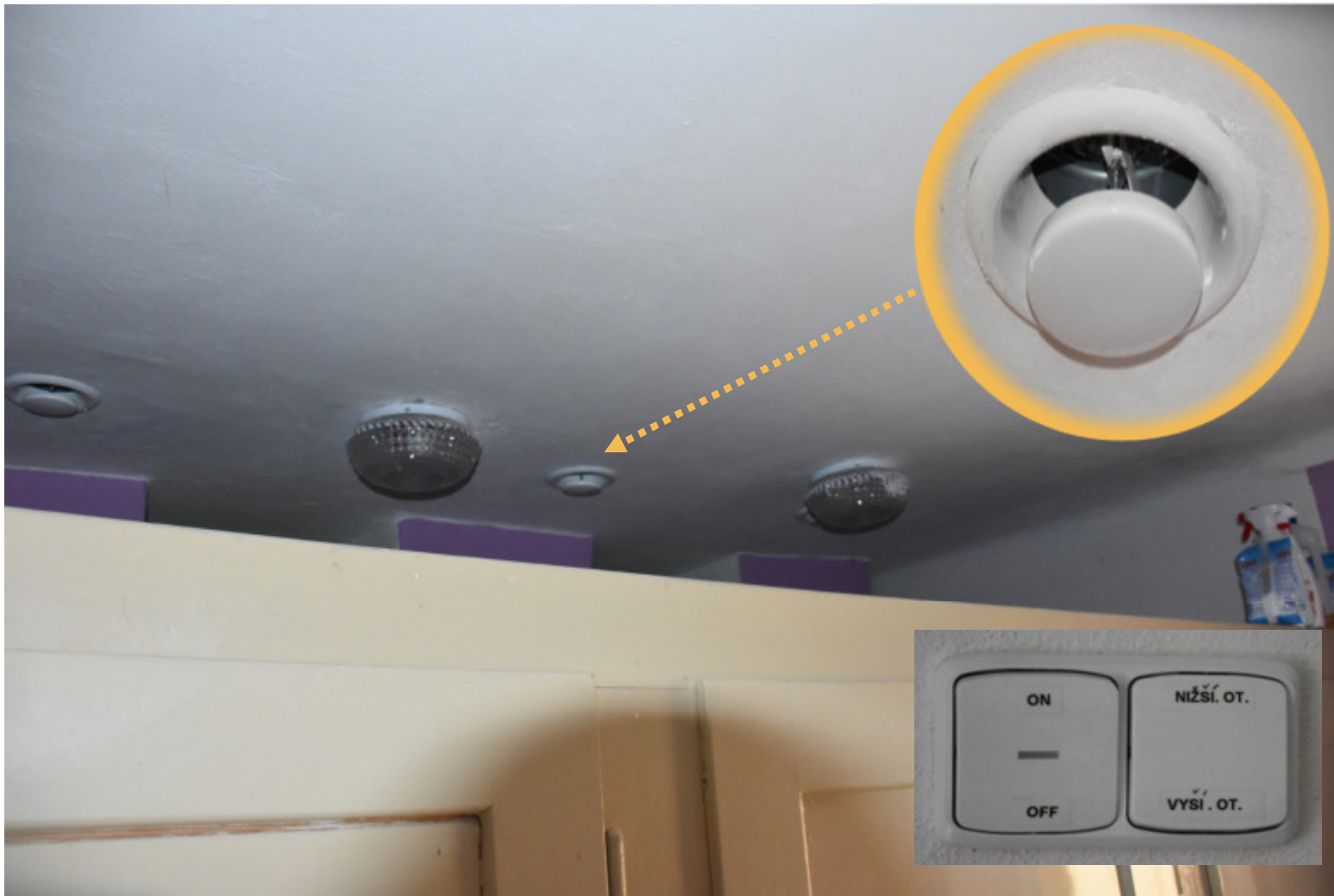
Obr. 2: Původní odtahové talířové ventily hygienického zařízení ZŠ Hudlice, zdroj: EkoWATT
