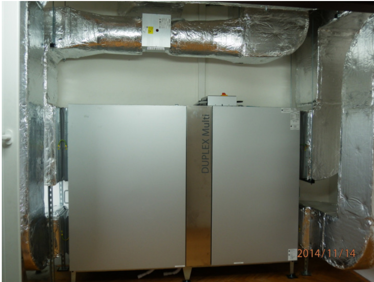
Obr. 9: Nová VZT jednotka s rekuperací tělocvičny ZŠ Kralovice, zdroj: EkoWATT
