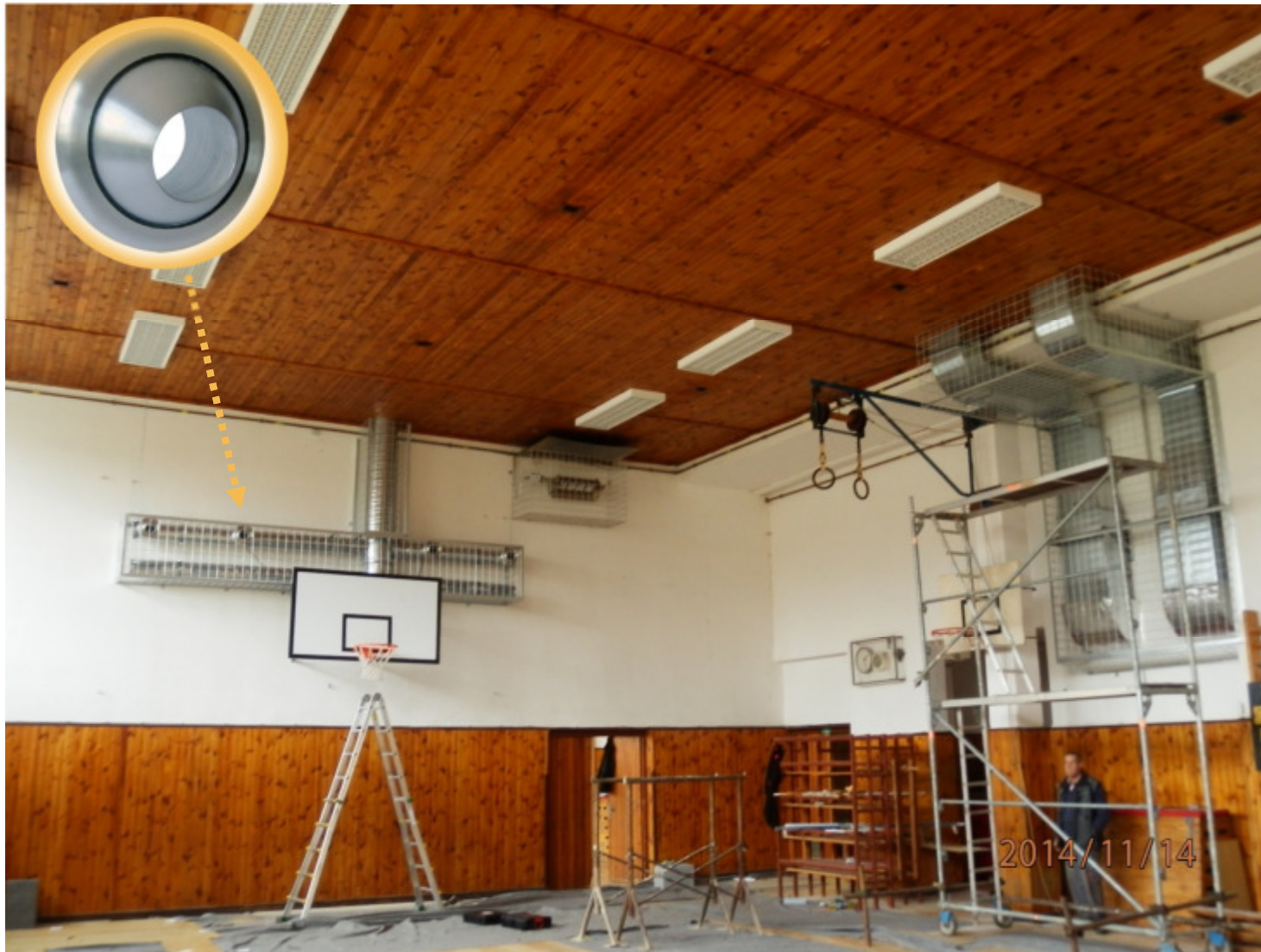
Obr. 10: Distribuce vzduchu dýzami pod stropem tělocvična ZŠ Kralovice, zdroj: EkoWATT
