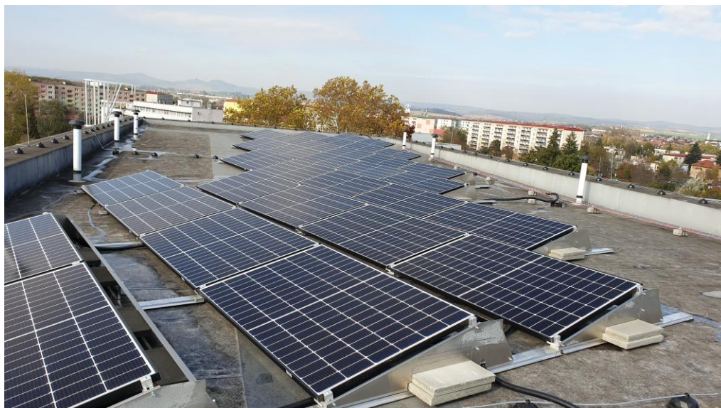
Obrázek 12: FVE na Uherskohradištské nemocnici COII
