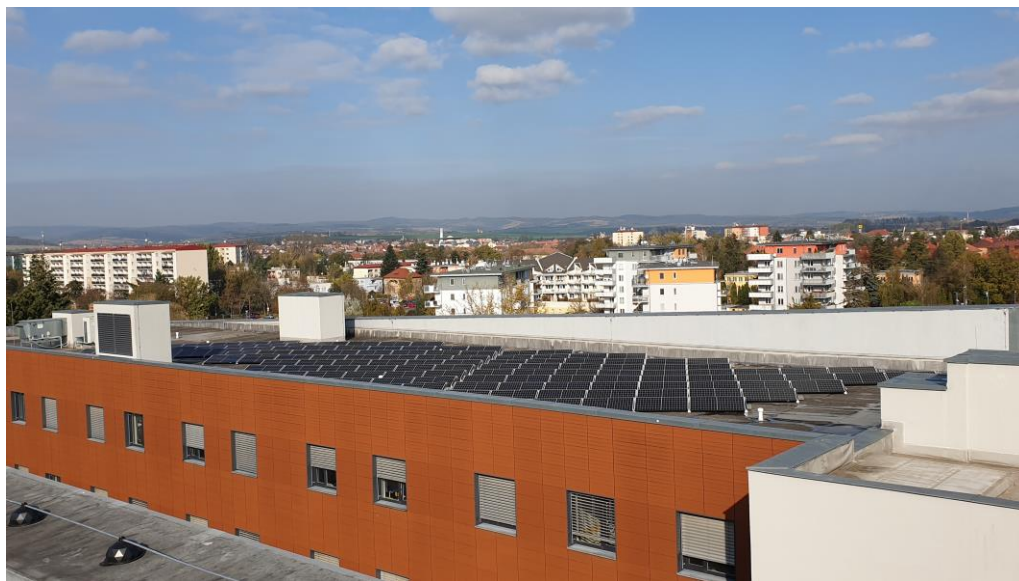
Obrázek 11: Fotovoltaický systém na nově vybudovaném pavilonu COI
